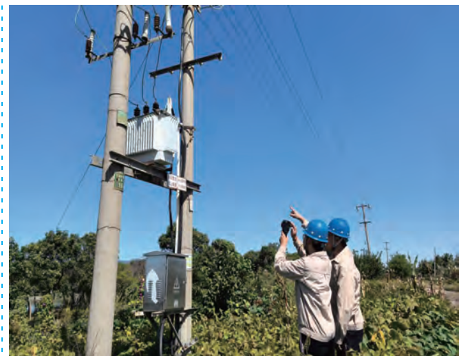
为确保“国庆”期间广大客户用电安全可靠，供电工程分公司提前谋划、统筹协调，多措并举打好电力保供攻坚战，全力护航国庆假期电力供应。(周国成)
